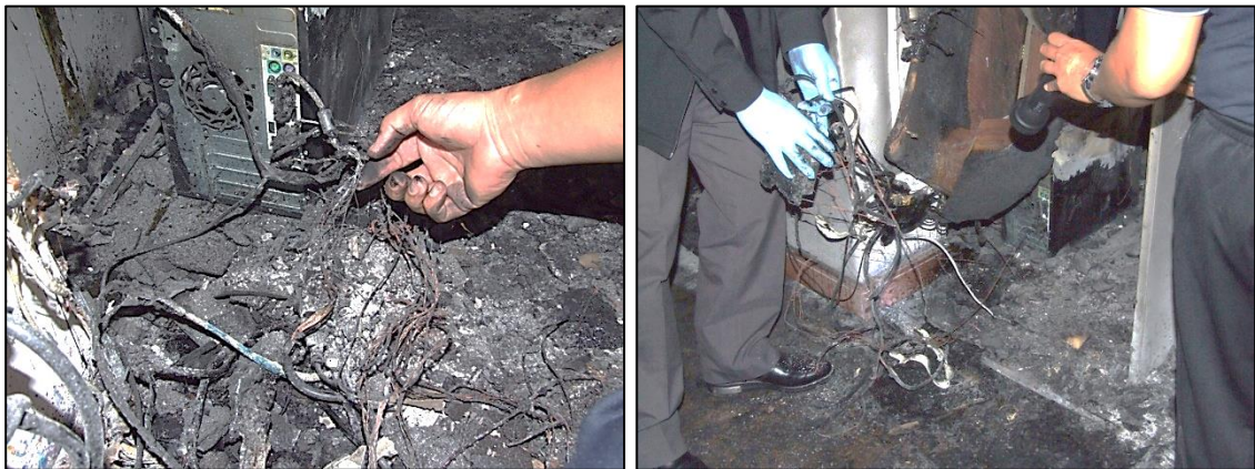
สายไฟฟ้าที่ถูกเพลิงไหม้ ณ จุดต้นเพลิง
